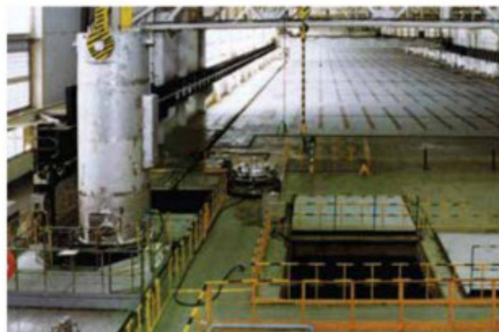
Общий вид «мокрого» хранилища ОЯТ
