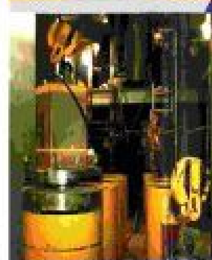
Установка цементации КРО, installation for cement solidification liquid radioactive waste (LRW).
