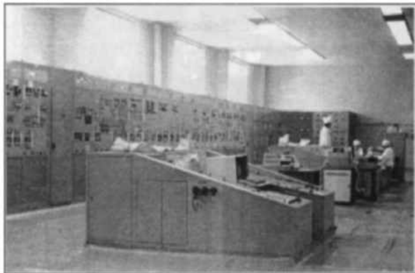
Здание 101, цех 2, ЦПУ - пульты управления отд. 7-10 и отд. 17.
