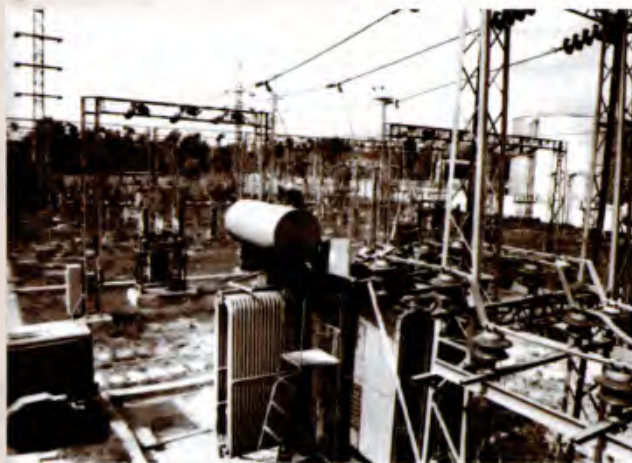
Понижительная подстанция ГПП-1
