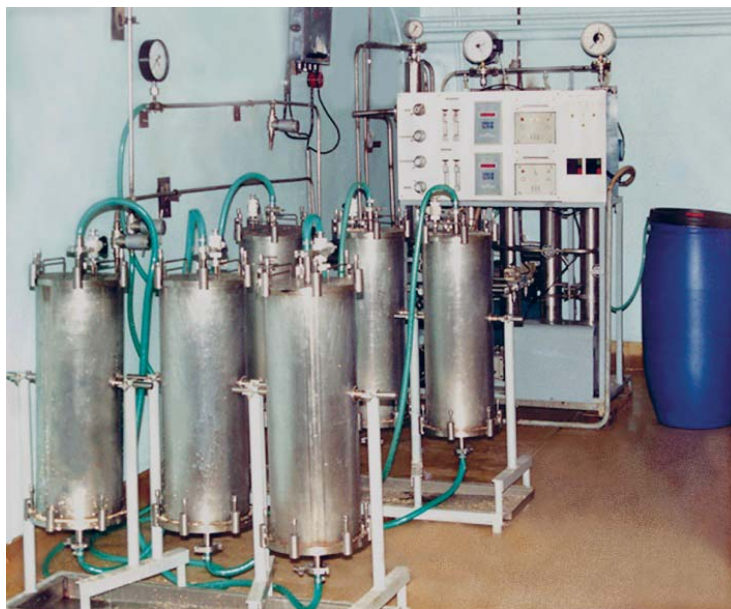
Модульная мембранно-сорбционная установка (ММСУ)
