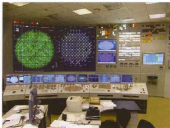
Блочный щит управления
