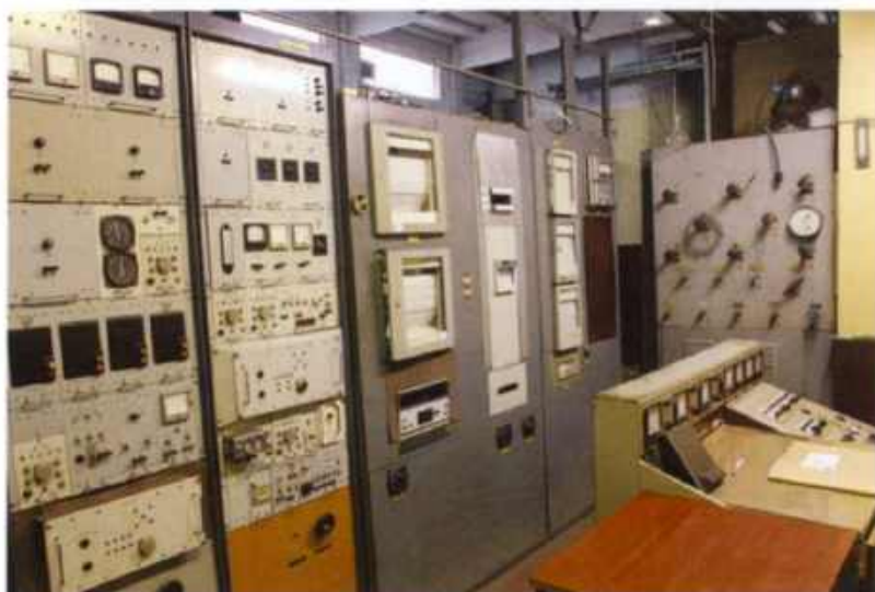
Пульт управления стенда приводов
