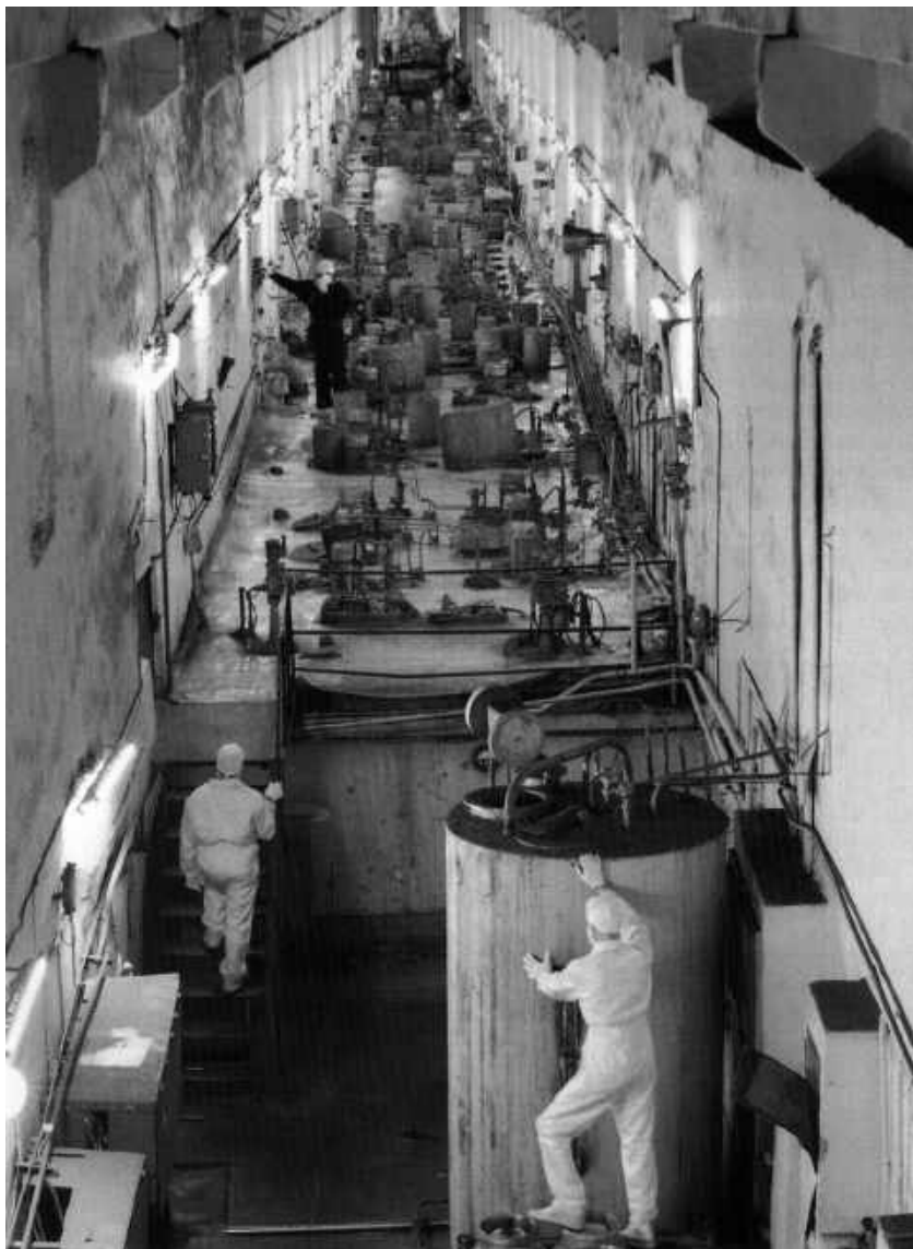
Монтажный зал одной из технологических ниток радиохимического завода. Радиационно-опасное оборудование – внизу под мощной бетонной защитой. Видны механизмы управления и верхние части контрольно-измерительных приборов
