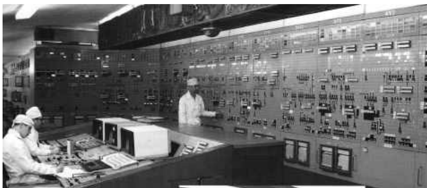
Щит управления радиохимическим производством
