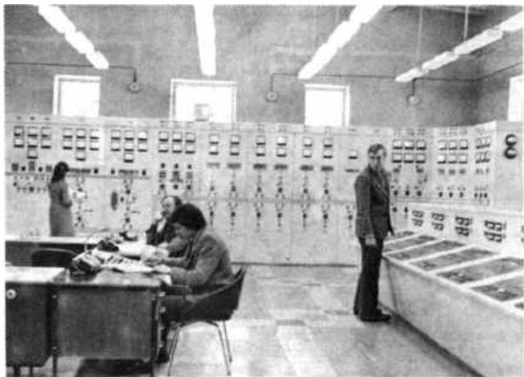
Пульт управления ГПП-1 цеха сетей и подстанций № 9
