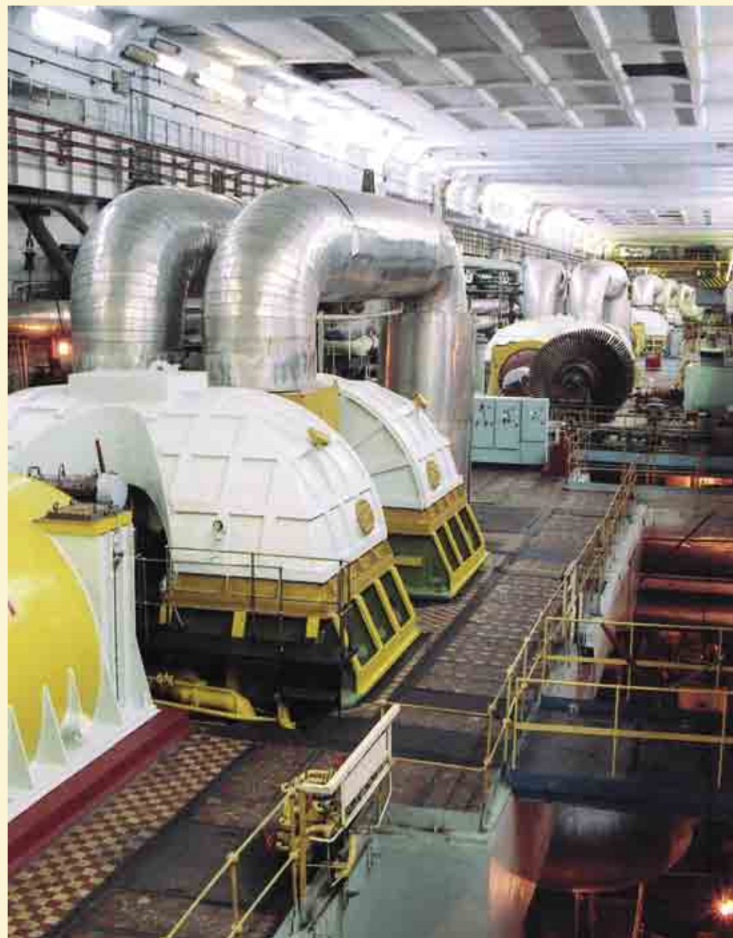
Турбинный зал подземной атомной теплоэлектроцентрали
