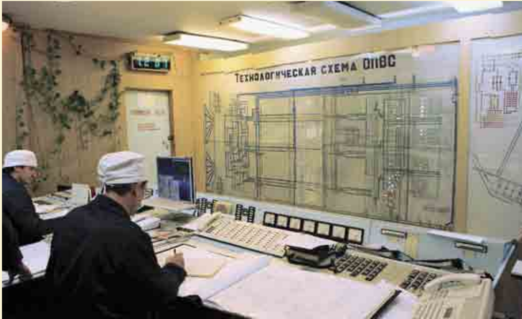
Щит управления водоснабжением реакторов
