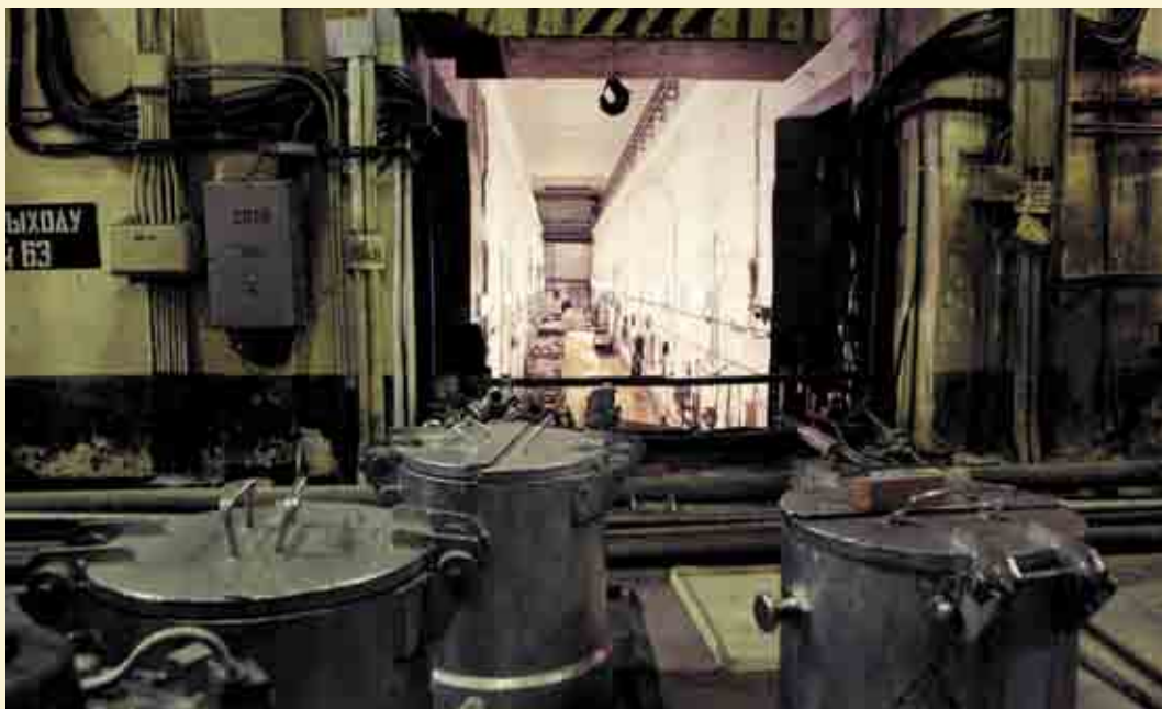
Цеха радиохимического завода — настоящий подземный лабиринт
