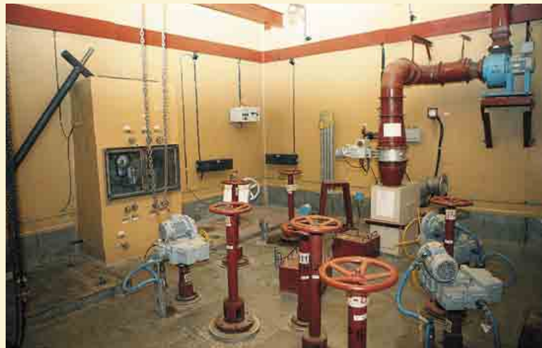
Насосная станция полигона «Северный»
