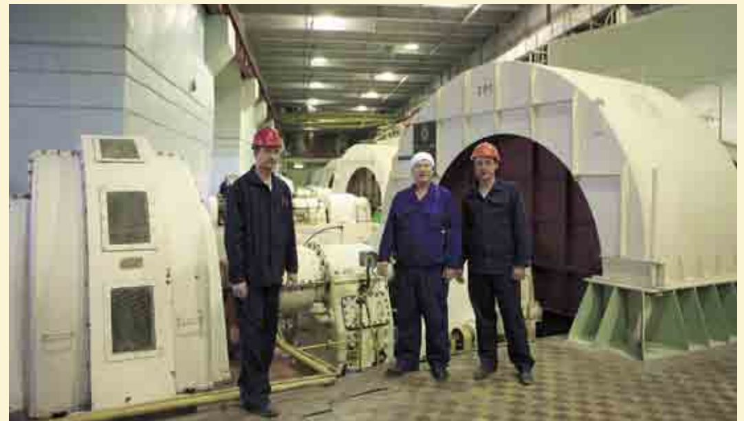
Первый вентилятор введен в эксплуатацию в 1957 году производительностью 5 млн куб. м в час
