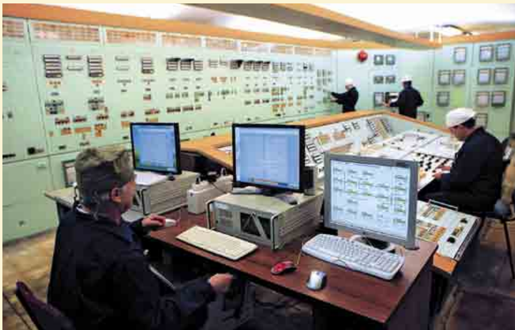
Щит контроля и управления технологическим процессом
