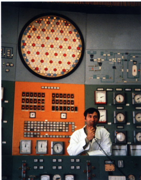
Блочный щит управления, 80-е годы. Старший инженер-оператор Е. Николаев
