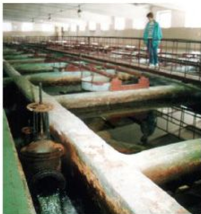
ИЭС-2 – сооружения первой ступени очистки
