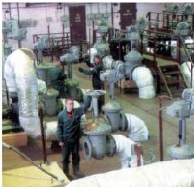
Насосно-подкачивающая станция-4, Южный район
