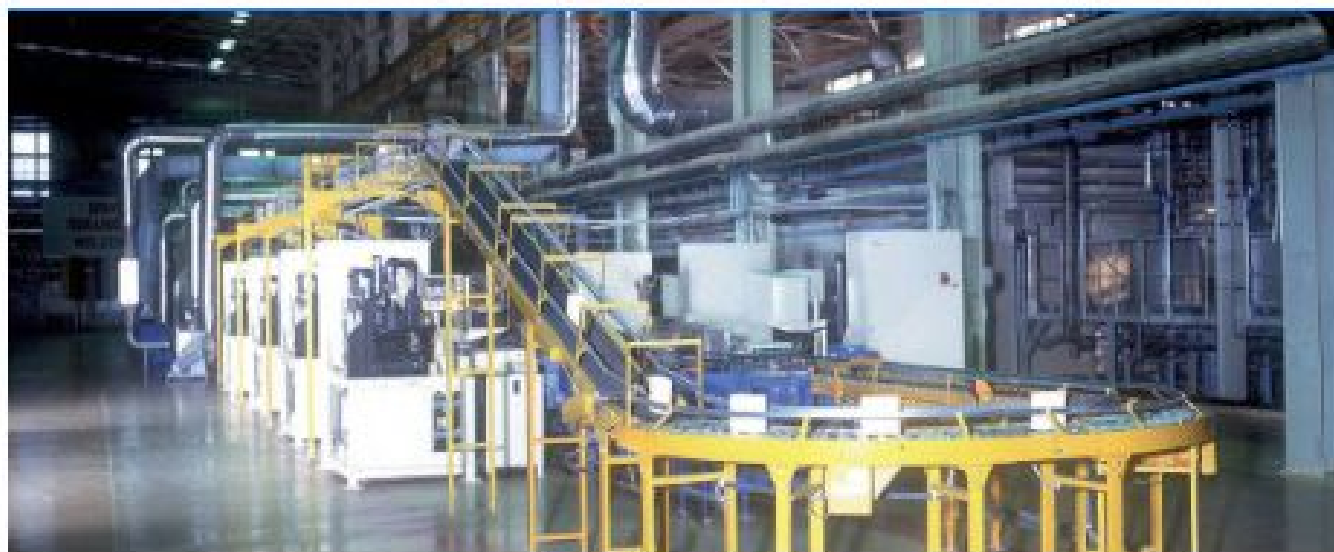
Конвейер производства нейтрализаторов выхлопных газов
