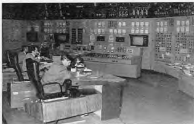
Блочный щит управления
