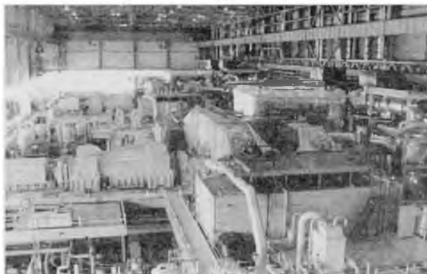
Машинный зал V блока
