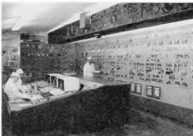
Пульт управления на радиохимическом заводе
