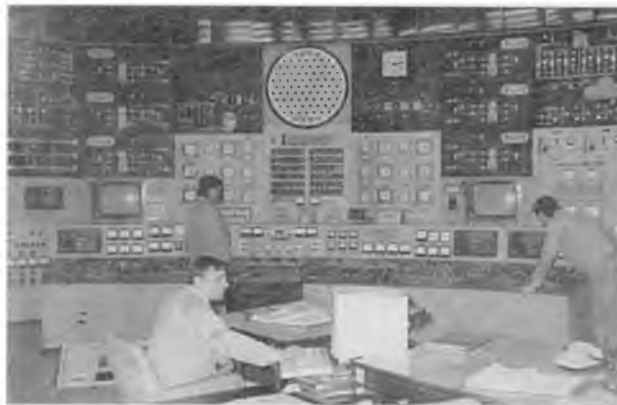
Блочный щит управления III блока
