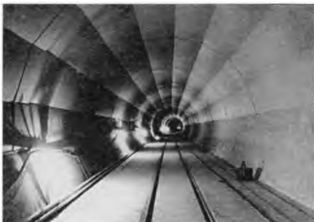
Участок кольцевого тоннеля УНК, подготовленный к началу монтажа электрофизического оборудования
