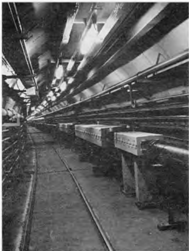
Канал транспортирования протонного пучка из ускорителя У-70 в первую ступень УНК (канал инжекции). Введен в 1994 г.
