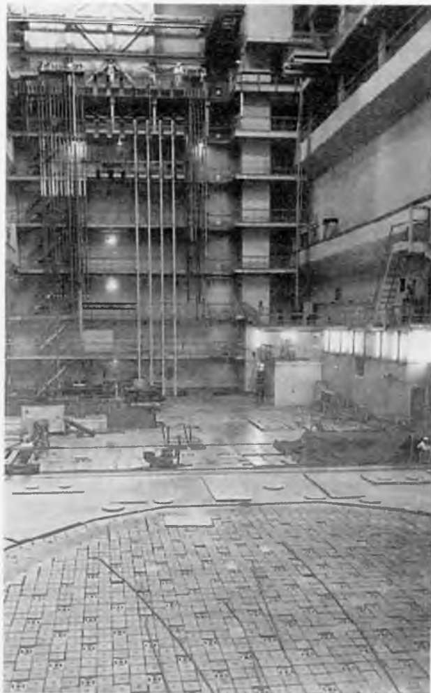
Центральный зал реакторного отделения I блока ЛАЭС
