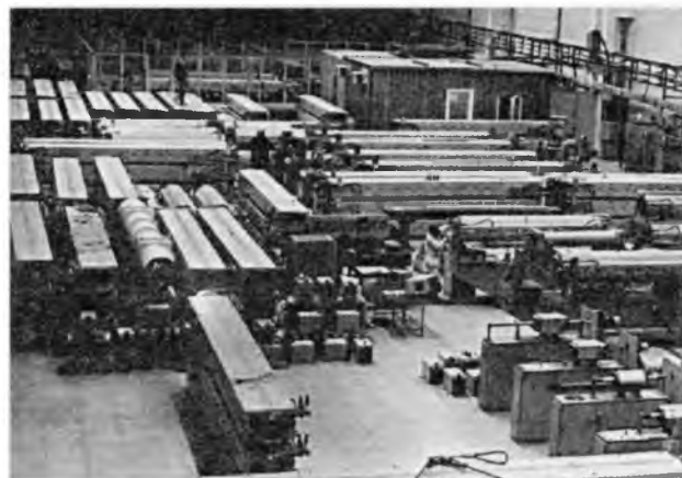
Зал предмонтажных испытаний электромагнитов производства НИИЭФА для первой ступени УНК
