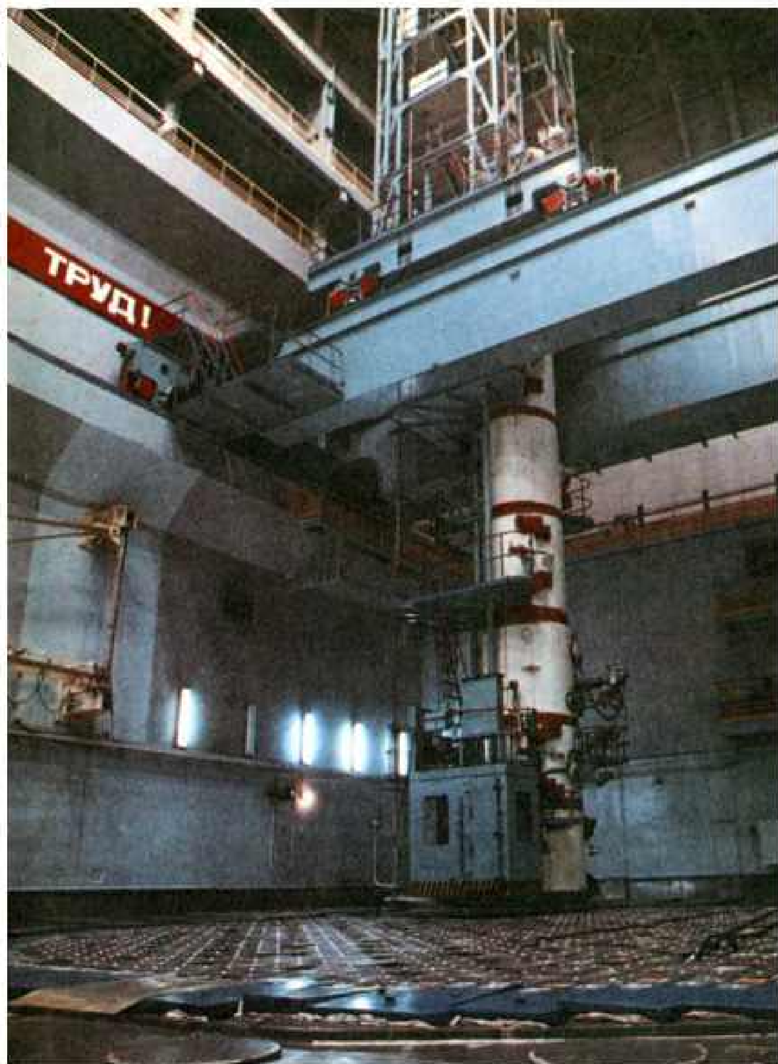
Разгрузочно-загрузочная машина для перегрузки топлива на работающем реакторе
