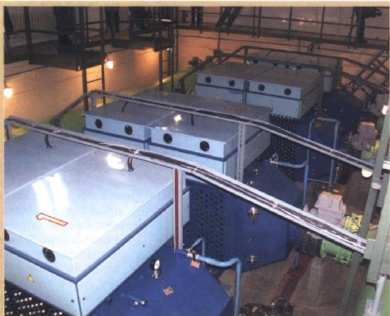
Часть очистного комплекса ОАО «ЧМЗ»
