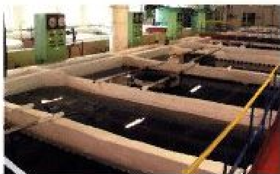
КОНТАКТНЫЕ ОСВЕТИТЕЛИ ФИЛЬТРОВАЛЬНОЙ СТАНЦИИ
