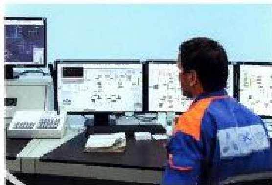
СТАРШИЙ МАШИНИСТ О.Л. САПТЫКОВ ВЕДЕТ КОНТРОЛЬ ЗА ПАРАМЕТРАМИ РАБОТЫ БЛОКА ПГУ
