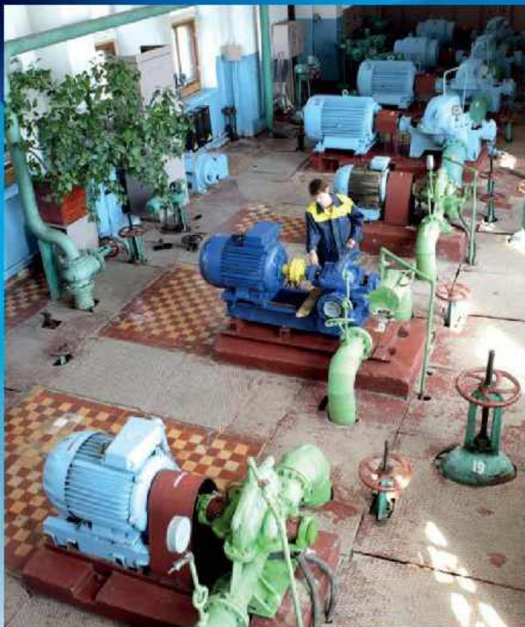
Завод «Гидроэнергоснаб» – это сердце и вены комбината. Общая длина всех находящихся в обслуживании коммуникаций составляет более 550 километров
