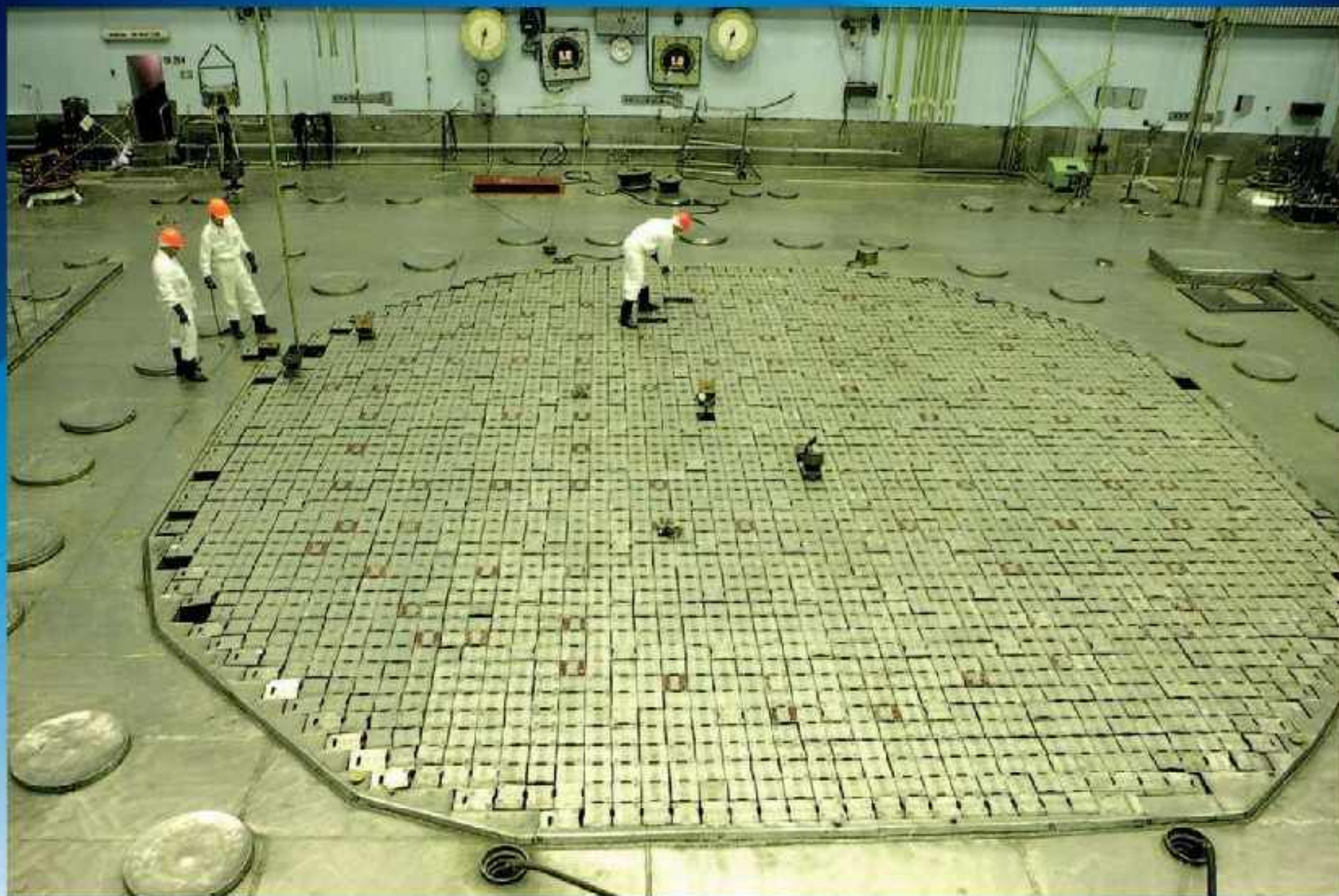
В центральном зале реакторного завода
