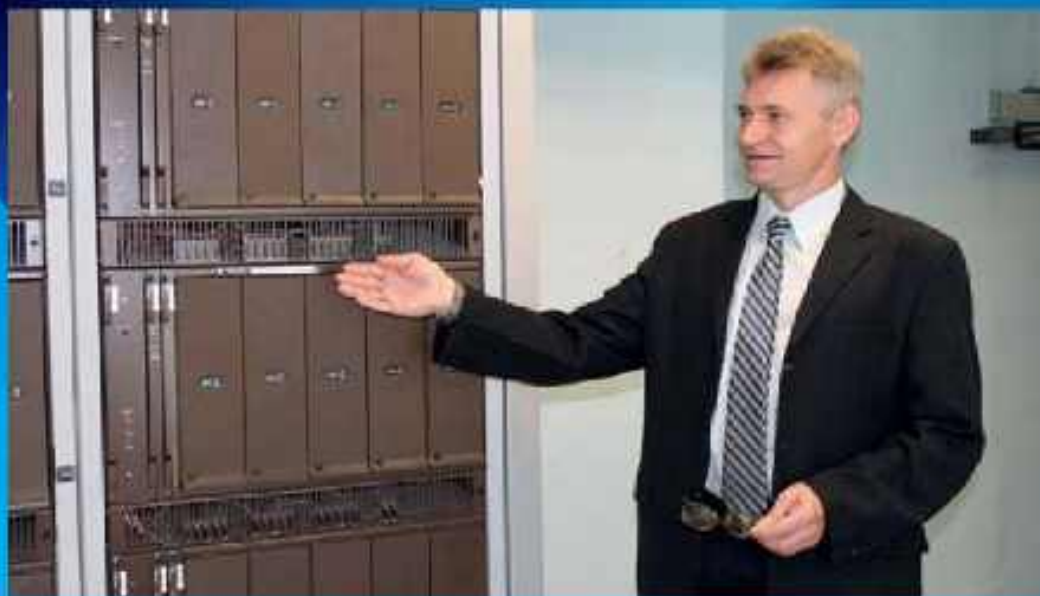
ООО «СТК», бывший цех связи СХК, обладает современным оборудованием
