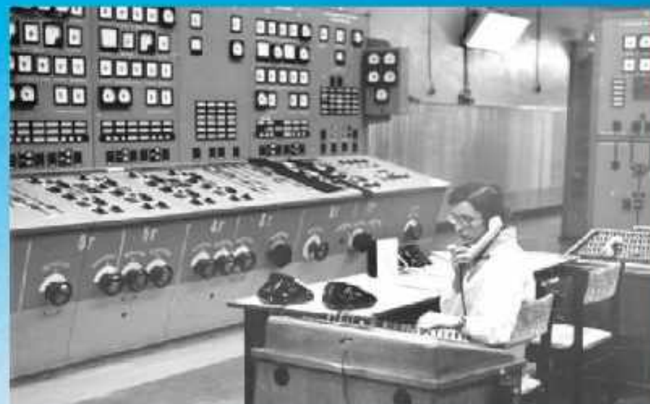
Объект 45. Пульт управления ЭС-2
