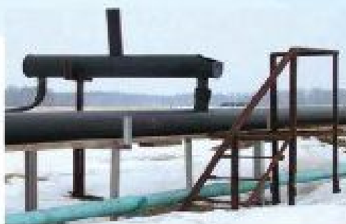
Трубопровод продуктивных растворов, смонтированный на эстакаде, с воздухоотделителем, оснащенный щелевыми расходомерами для замера производительности откачной скважины
