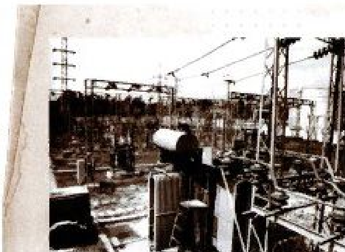
Понижительная подстанция ГПП-1
