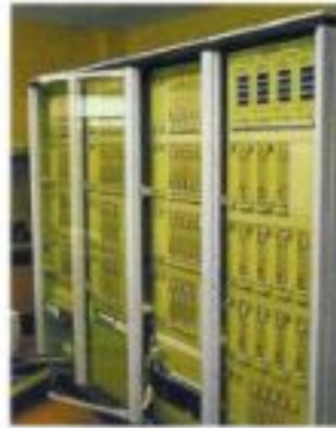
Автоматизированная система контроля механических величин (АСКМВ) непрерывно контролирует техническое состояние вращающегося оборудования энергоблоков АЭС – газовых и паровых турбин, главных циркуляционных насосов
