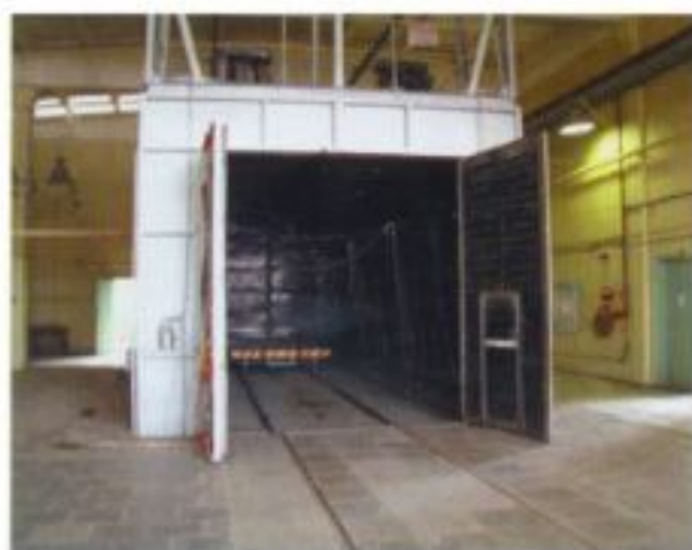
Большая тепловая камера
