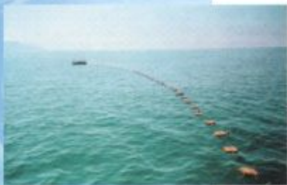
Понтон с испытательной установкой и подводный кабель
