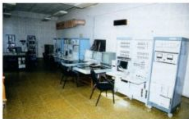
Автоматизированная система управления и контроля работы установок комплекса «Пульсар»
