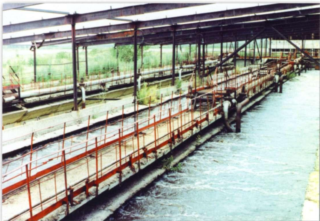
Очистные сооружения. Аэротенки
