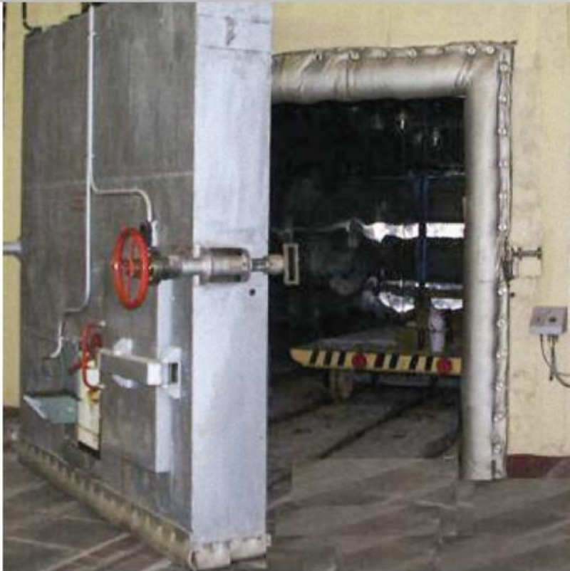
Общий вид большой холодильной камеры
