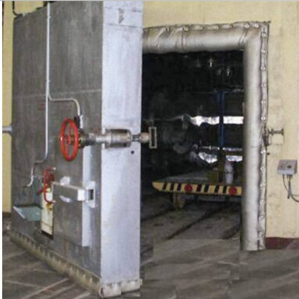
Общий вид большой холодильной камеры
