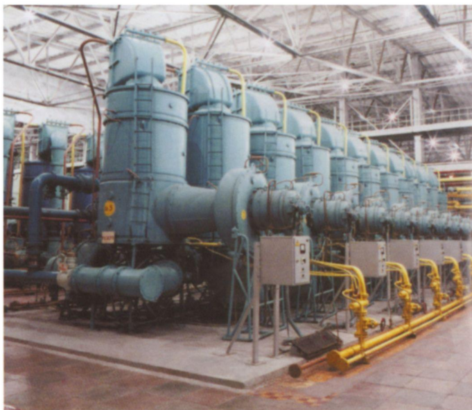
УЭК. Блок газодиффузионных машин
