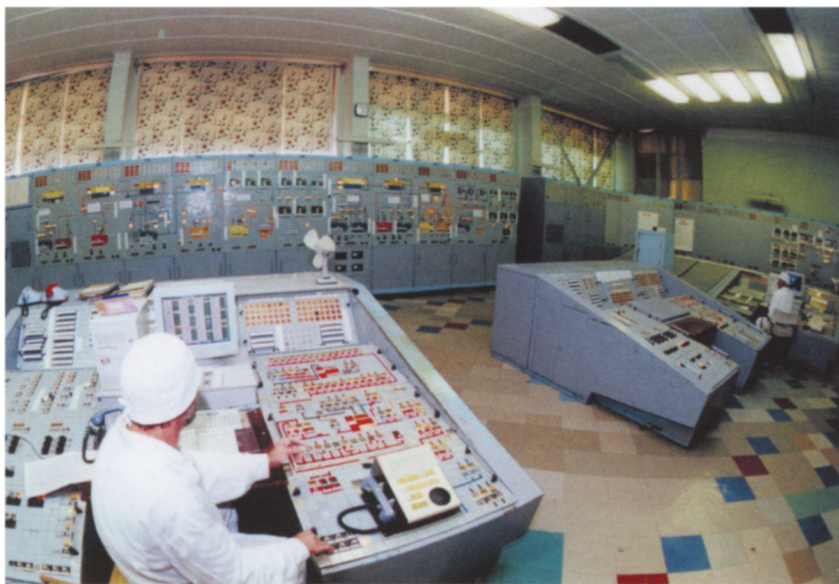
Производственное объединение «Маяк», завод РТ-1, щитовая
