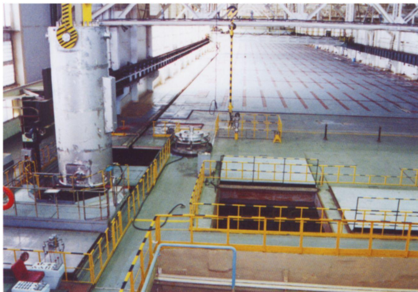
«Мокрое» хранилище ОЯТ завода РТ-2, ГХК, г. Железногорск
