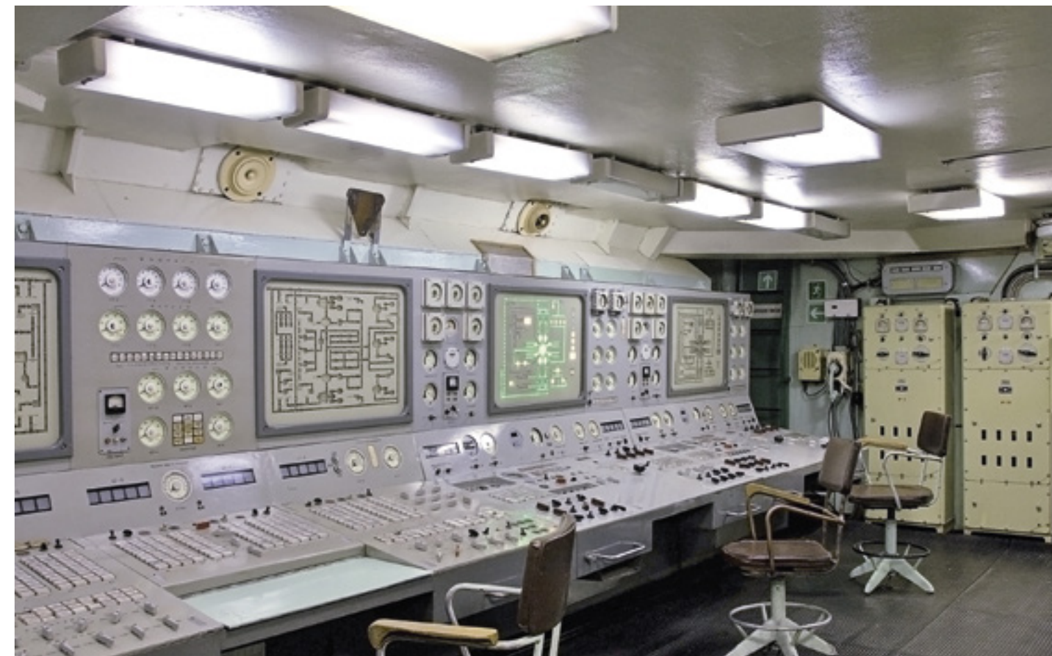
Пульты управления реакторами атомной паропроизводящей установки ОК-900
