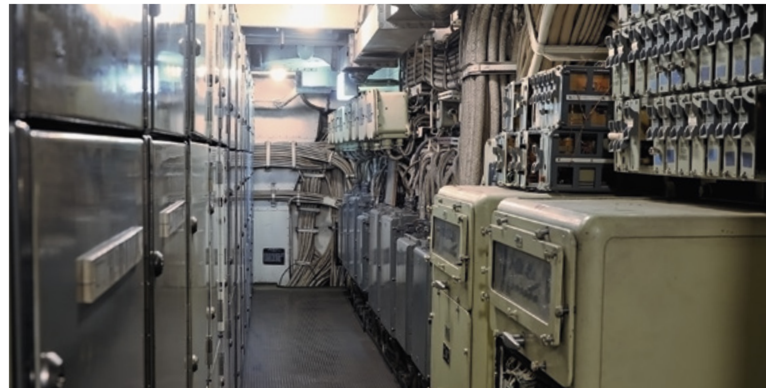
Комплекс МЦК «Полюс» и связанное с ним оборудование занимает целиком еще одно помещение СУЗ
