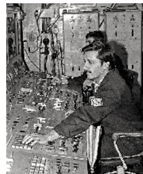
Инженеры-операторы за пультами управления АППУ на посту энергетики и живучести. 1970-е гг.
