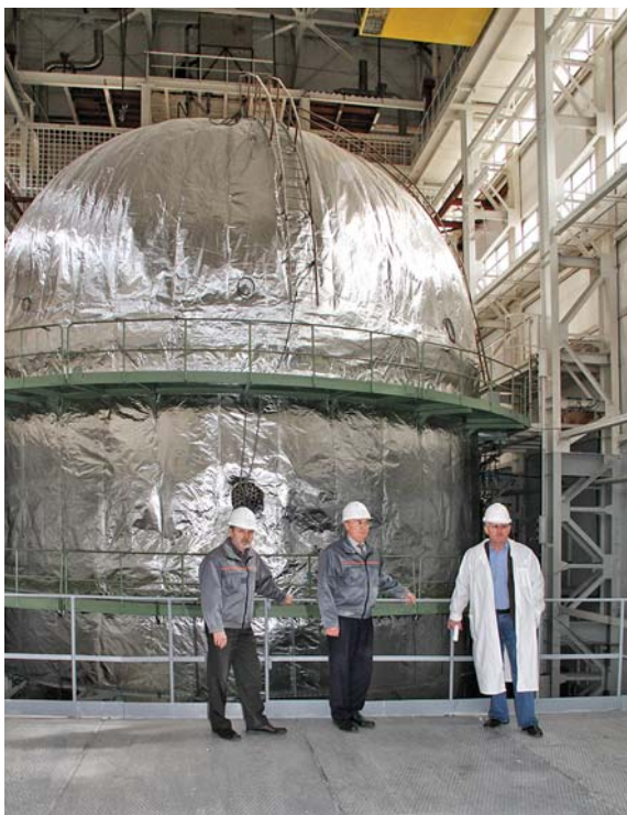
Контейнер реакторной установки
