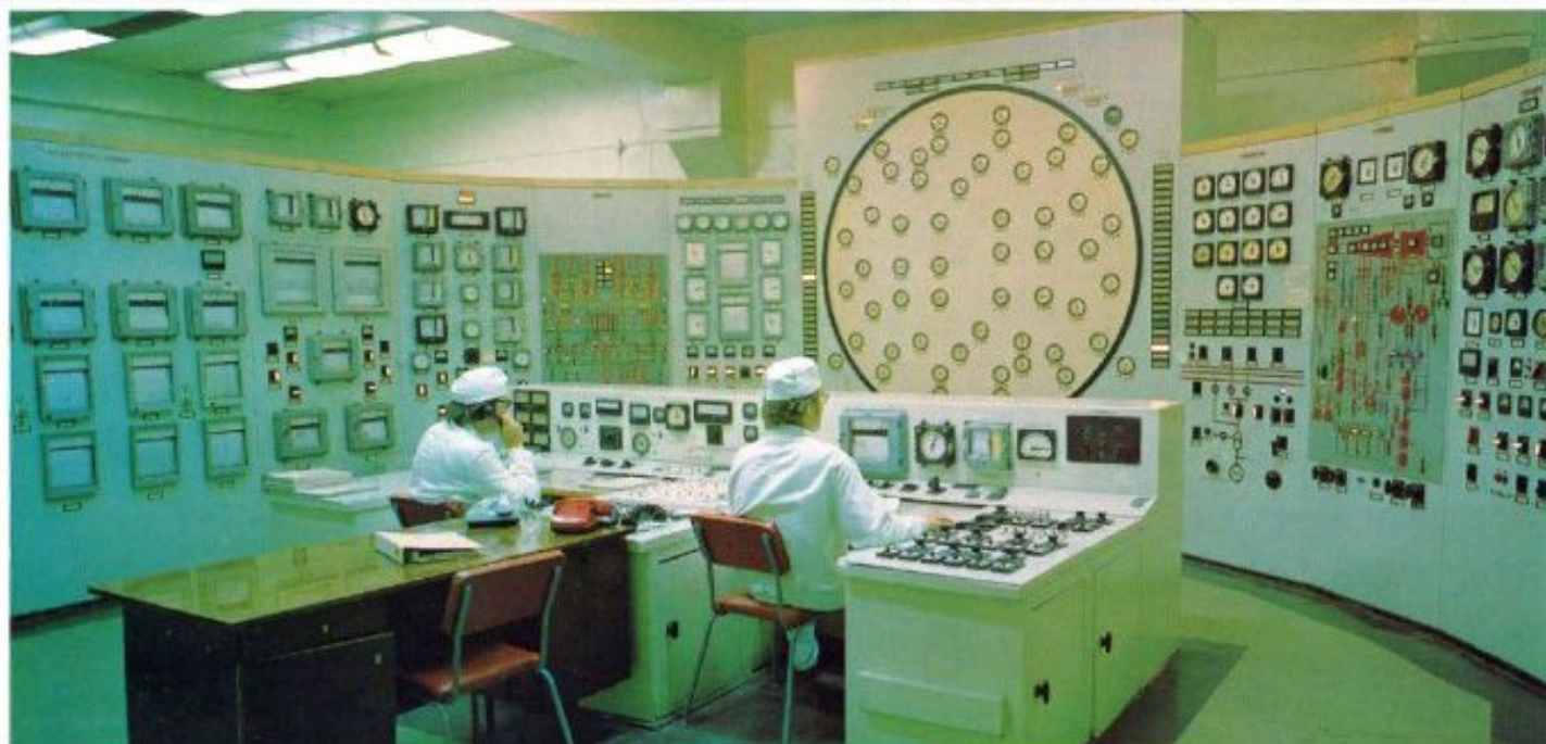
Главный щит управления Блочный щит управления
