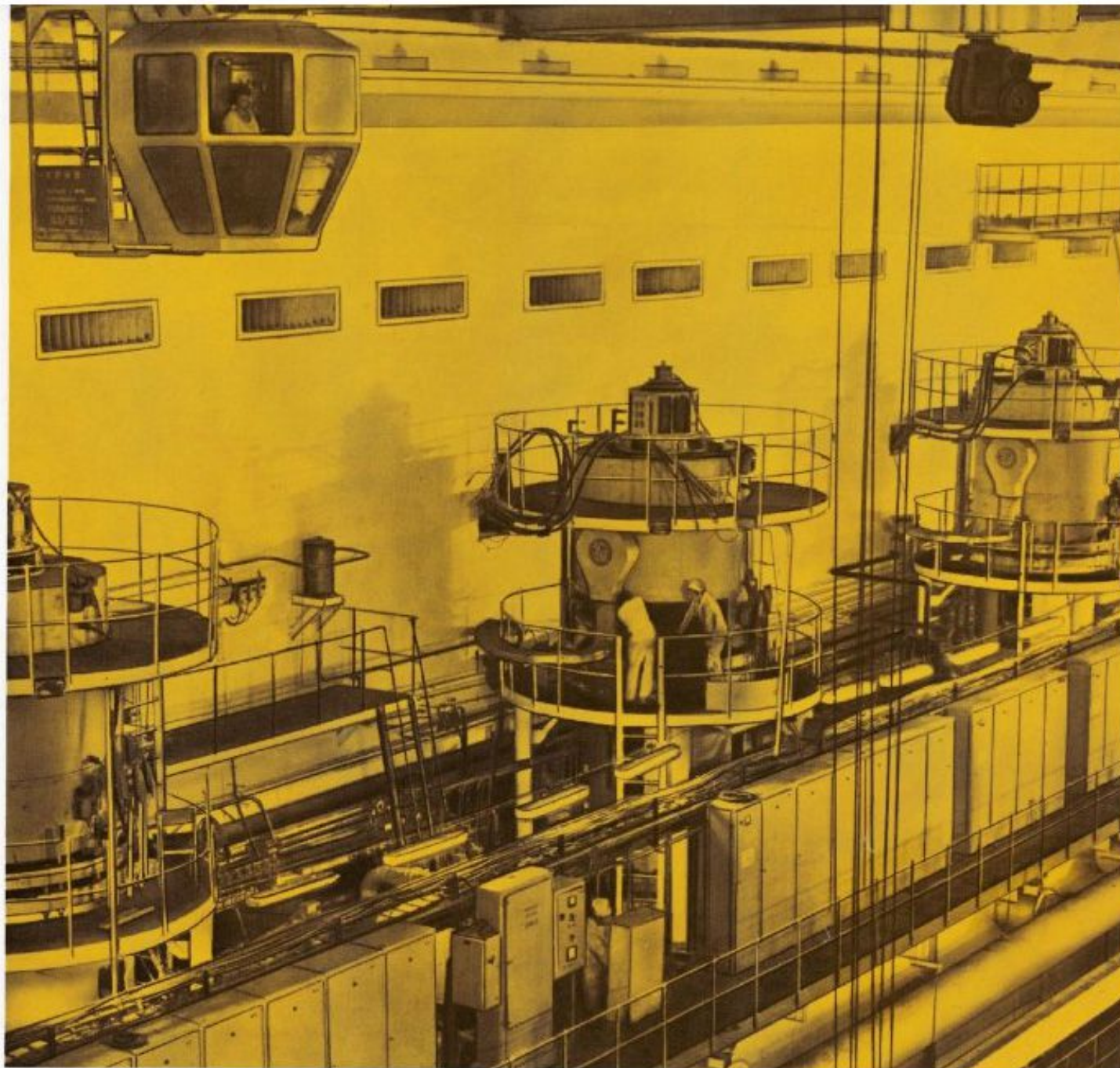
Главные циркуляционные насосы II контура
